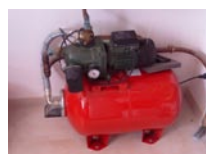
surpresseur de la cuve
