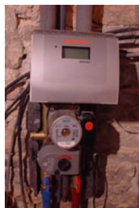
Une régulation, son circulateur et sa vanne 3 voies
