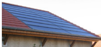
Les capteurs photovoltaïques
