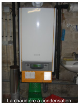
La chaudière à condensation
