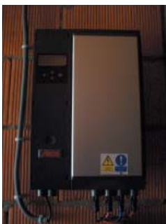
L'onduleur adapte l'électricité solaire au réseau
