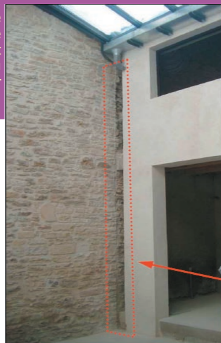
Le mur de refend qui soutient la verrière a lui aussi été construit avec un vide à sa jonction avec le mur mitoyen
