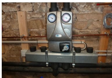
circulateur qui gère le départ et l'arrivée du circuit hydraulique
