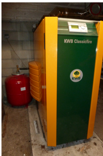
La chaudière bûche et son vase d'expansion
