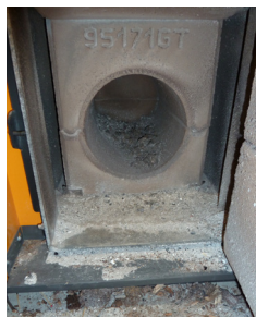
chambre de gazéification
