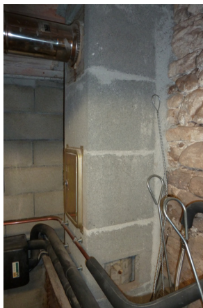
conduit de cheminée
