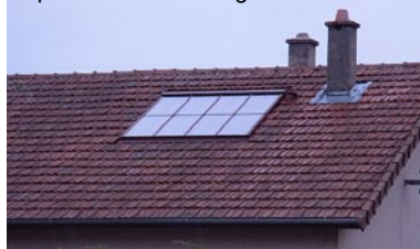
Capteurs solaires intégrés en toiture
