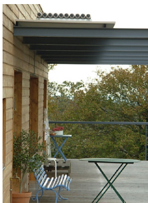
Capteurs solaires tubulaires implantés en casquette
